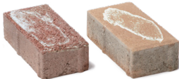
Dlažba s výkvětem
